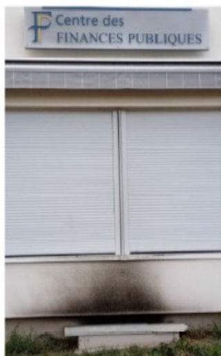
L'incendie s'est déclaré au niveau du soupirail. Photo JSL / Danièle LAVENTR
